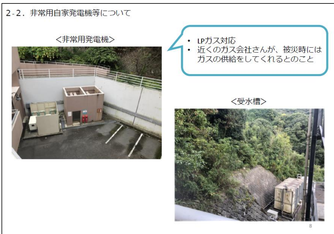
図表 4-2-20 施設の備蓄・非常用設備 51
